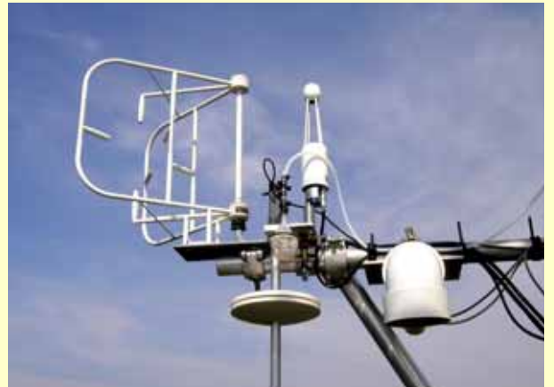
タワーに設置された測定システム
