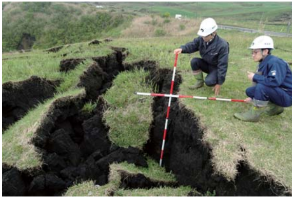
写真－7 かぶと岩展望所周辺の亀裂
