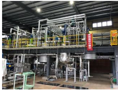
写真2 プラント内部
