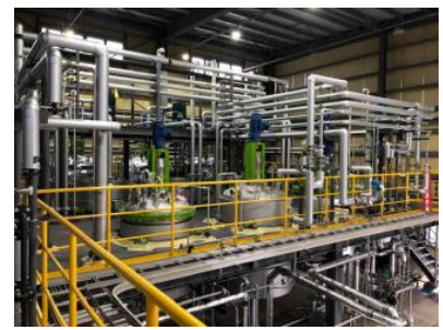
写真3 プラント内部
