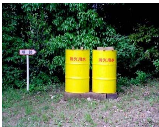
写真－10 消防用水
