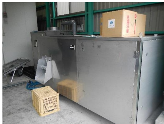
小容量処理槽
