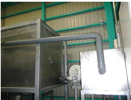
集じん機と脱臭装置
